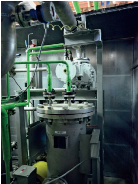
Abb. 2: Zwischenkühler zur Gewährleistung der vorgegebenen Maximaltemperatur
